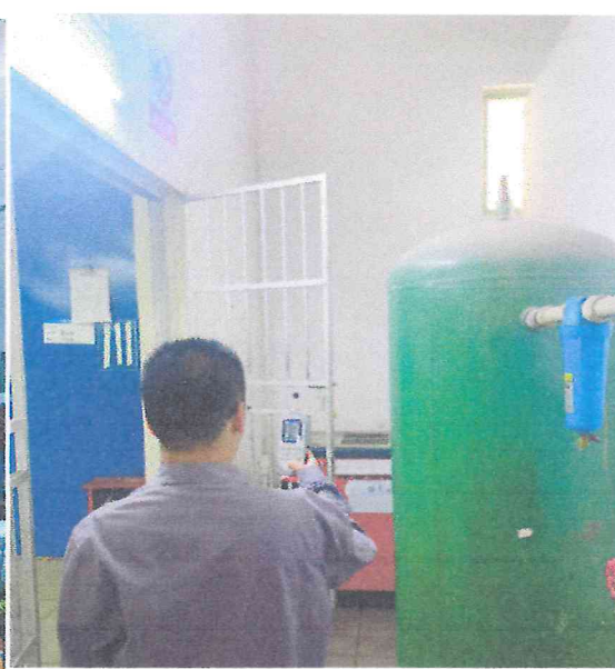
空压机采样照片
