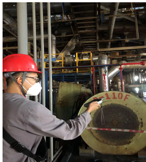
2023 年 5 月 30 日氧化反应器进料泵巡检位 P-110 噪声检测
